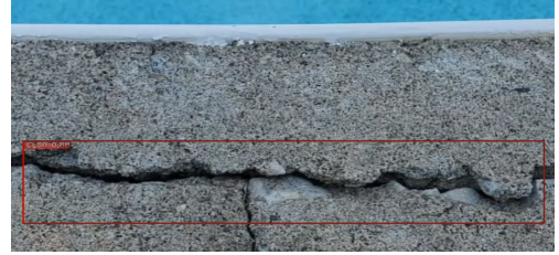
(d) Detection on Uneven Concrete Surface
