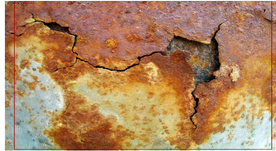
(d) Detection on Uneven Surface
